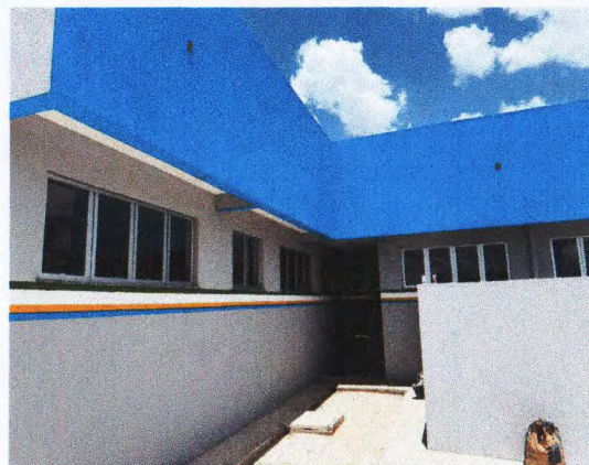
VIDROS E ESQUADRIAS
