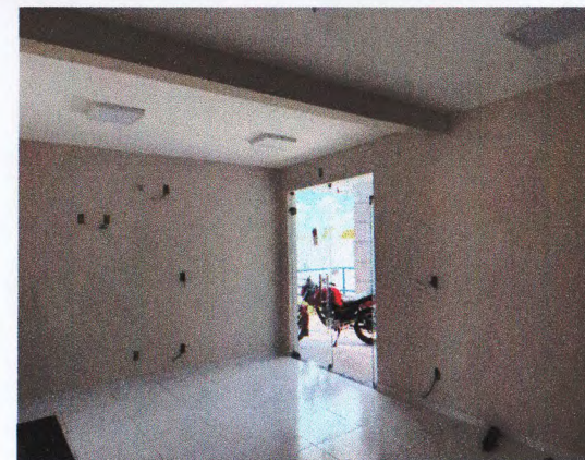
VIDRO E INSTALAÇÕES ELÉTRICAS
