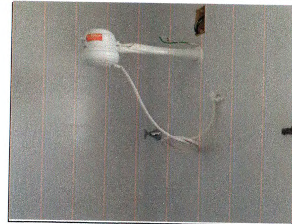
CHUVEIRO ELÉTRICO E REGISTRO
