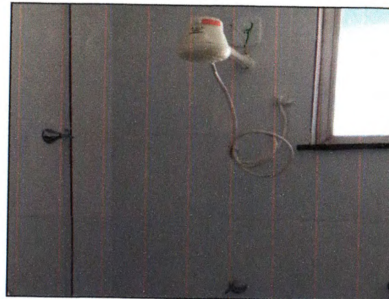
CHUVEIRO ELÉTRICO E REGISTROS
