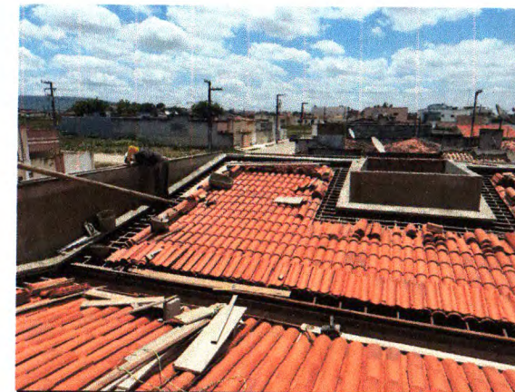
MANTA ASFÁLTICA NO RUFO
