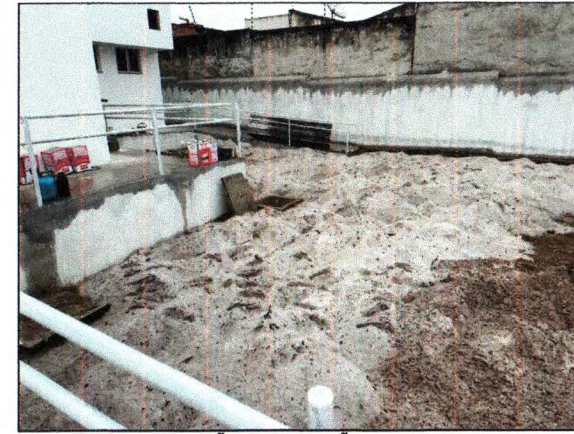
CORRIMÃO E COLCHÃO DE AREIA
