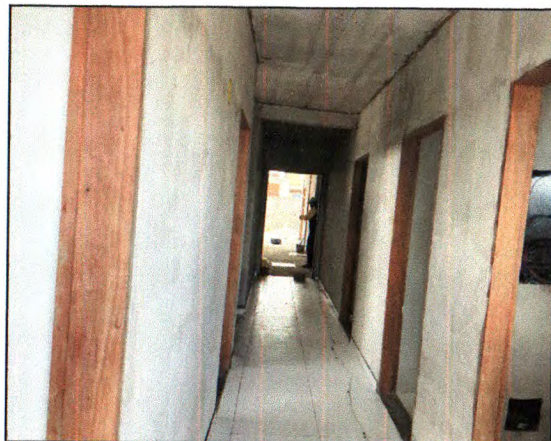
SOLEIRAS E REBOCO NO TETO
