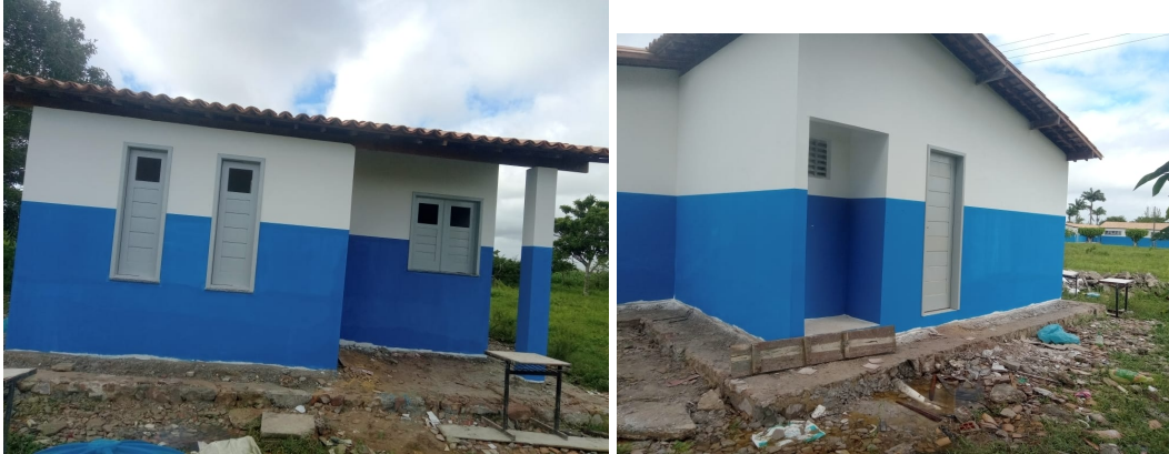
Fotos 05. Casa do Vigia 02 após a Pintura Externa e instalação de portas e janelas
