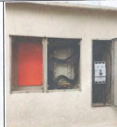
QUADRO DE MEDIÇÃO INDIRETA E EQUALIZAÇÃO DA SUBSTACÃO
