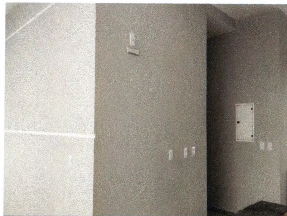
PINTURA INTERNA; QUADRO DE DISJUNTORES; INTERRUPTORES; LUMINÁRIA DE EMERGÊNCIA
