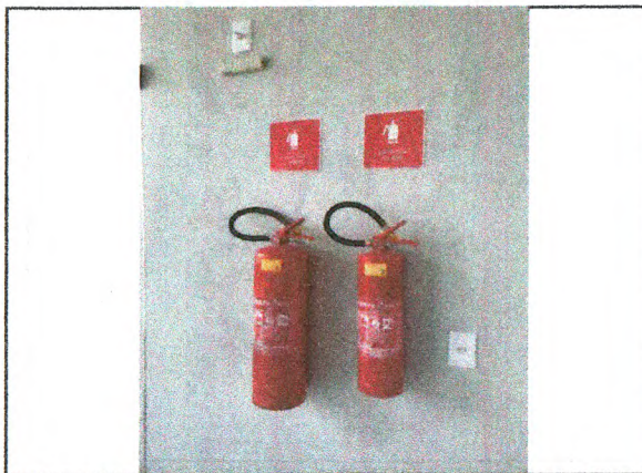
EXTINTORES; PLACAS DE SINALIZAÇÃO; LUMINÁRIA DE EMERGÊNCIA
