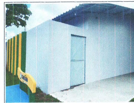
PORTÃO EM FERRO
