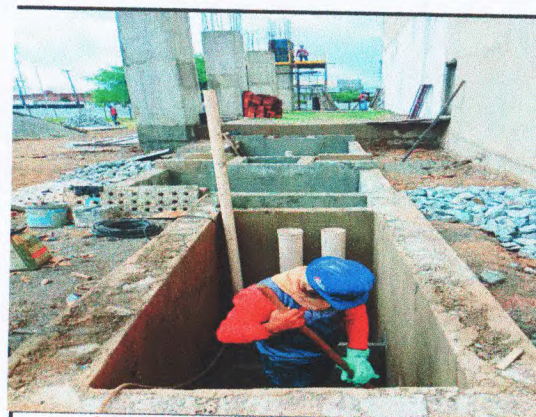
SISTEMA DE TRATAMENTO DE ESGOTO
