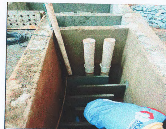
SISTEMA DE TRATAMENTO DE ESGOTO
