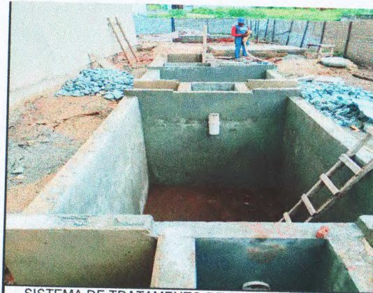
SISTEMA DE TRATAMENTO DE ESGOTO - FOSSA E FILTRO
