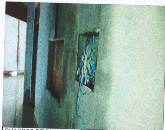
QUADROS DE DISTRIBUIÇÃO; ELETRODUTOS EM PVC
