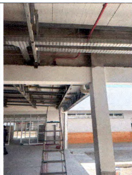
Figura 04: infra e cabeamento de alarme de incêndio.
