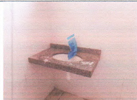
Figura 04 Instalação de Bancadas com cuba de embutir oval, sifão, válvula, engate e torneira.
