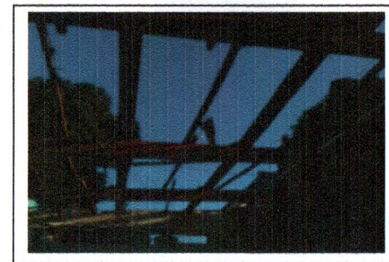
REVISÃO DE COBERTURA (FARMÁCIA)
