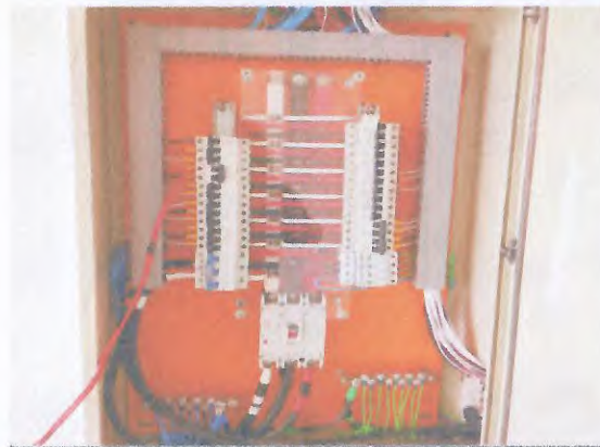
INSTALAÇÕES ELÉTRICAS - DISJUNTORES
