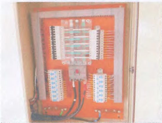
INSTALAÇÕES ELÉTRICAS - DISJUNTORES
