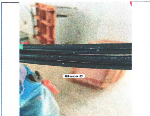
INSTALAÇÃO ELÉTRICAS - CABOS
