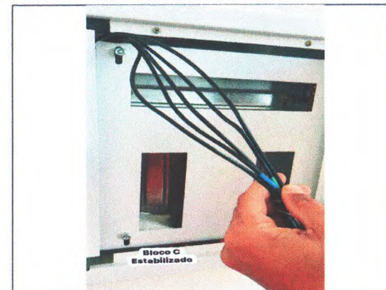
INSTALAÇÃO ELÉTRICAS - CABOS
