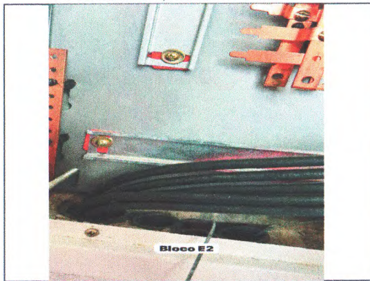
INSTALAÇÃO ELÉTRICAS - CABOS
