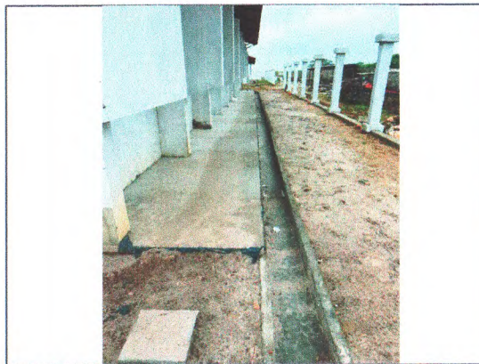
PISO EM CONCRETO DESEMPOLADO; CALHA EM CONCRETO
