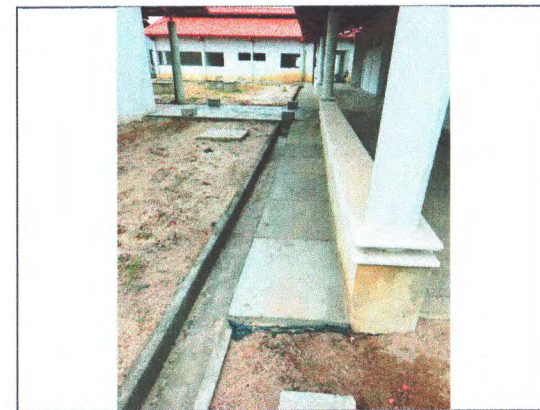
PISO EM CONCRETO DESEMPOLADO; CALHA EM CONCRETO
