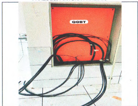
INSTALAÇÃO ELÉTRICAS - CABOS
