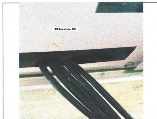
INSTALAÇÃO ELÉTRICAS - CABOS
