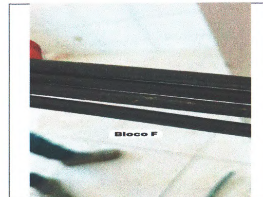
INSTALAÇÃO ELÉTRICAS - CABOS
