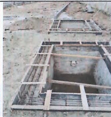
Tanque séptico e filtro anaeróbico
