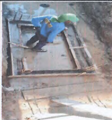
Tanque séptico e filtro anaeróbico
