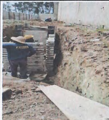
Tanque séptico e filtro anaeróbico
