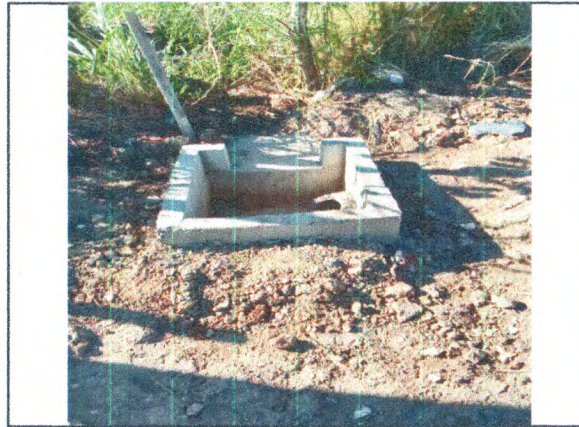
CAIXA DE PASSAGEM
