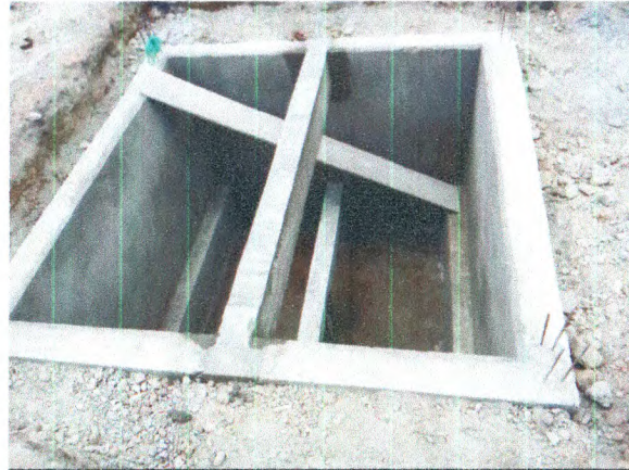
FILTRO - PLACAS E CALHA EM CONCRETO ARMADO
