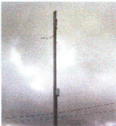
Quadro de distribuição de energia em pvc, inclusive Eletroduto de pvc rígido, Relé fotoelétrico para comando de iluminação externa e demais
