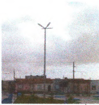
(Engastamento de Poste 3 com Luminária em LED)
