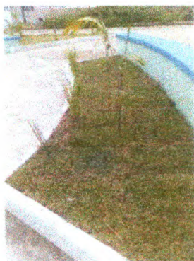
Fornecimento e plantio de Plantas, Plantio de grama em placas, inclusive Aplicação de adubo em solo
