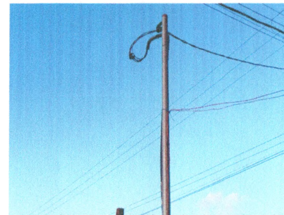
POSTE DE MEDIÇÃO TRIFÁSICA
