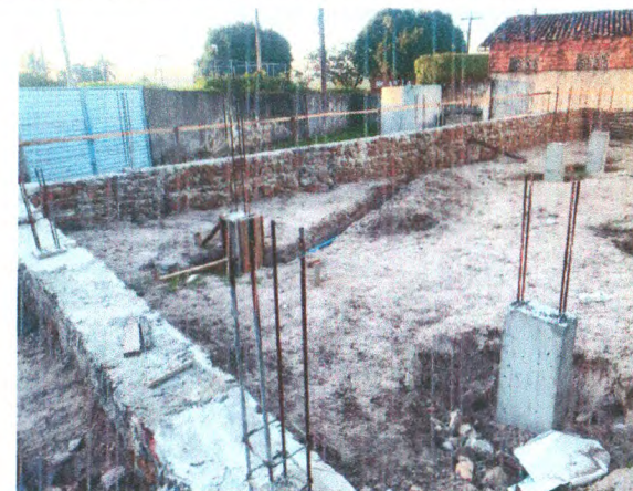
LOCAÇÃO EM GABARITO DE MADEIRA; ALVENARIA DE PEDRA ARGAMASSADA; SAPATAS E ARRANQUES;
