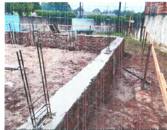
LOCAÇÃO EM GABARITO DE MADEIRA; ALVENARIA DE PEDRA ARGAMASSADA; SAPATAS E ARRANQUES
