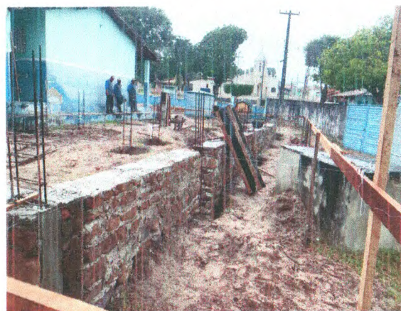
LOCAÇÃO EM GABARITO DE MADEIRA; ALVENARIA DE PEDRA ARGAMASSADA; SAPATAS E ARRANQUES
