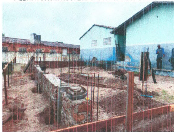
LOCAÇÃO EM GABARITO DE MADEIRA; ALVENARIA DE PEDRA ARGAMASSADA; SAPATAS E ARRANQUES; ATERRO COMPACTADO
