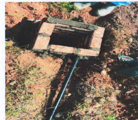
CAIXA DE PASSAGEM EM ALVENARIA
