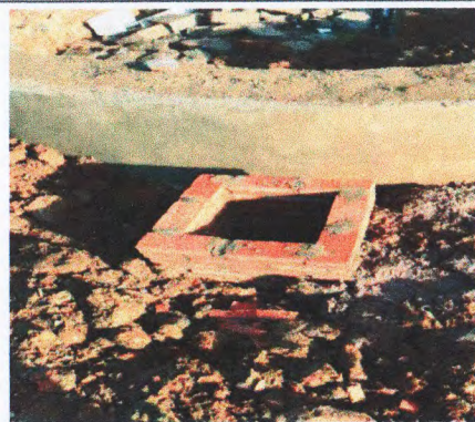
CAIXA DE PASSAGEM EM ALVENARIA
