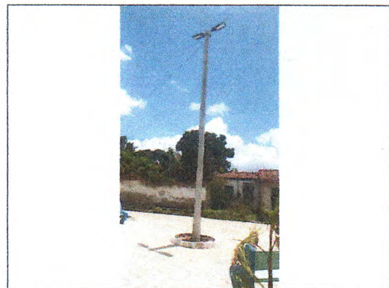
Poste e Luminárias LED
