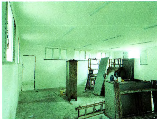
Foto 21. Biblioteca e sala de informática com forro em placas de gesso finalizado, com instalação de luminárias e esquadrias em alumínio. Emassamento de paredes e pintura realizada
