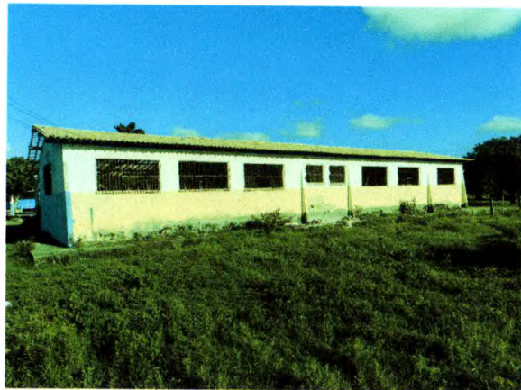
Foto 03. Remoção de esquadrias das janelas e início da demolição do reboco externo.
