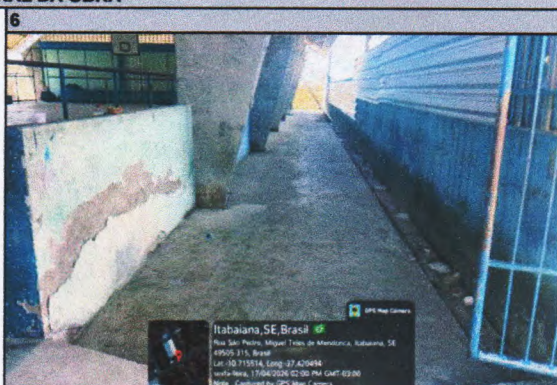
Imagem 6 - Concreto do passeio
