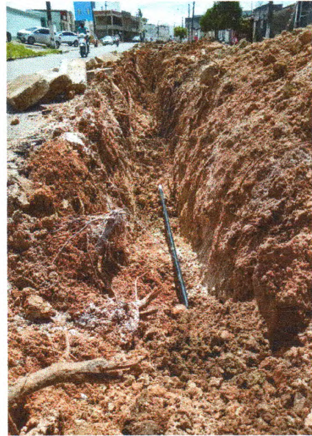
Tubulação de PVC enterrada
