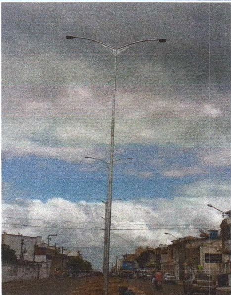
Poste de aço com luminária
