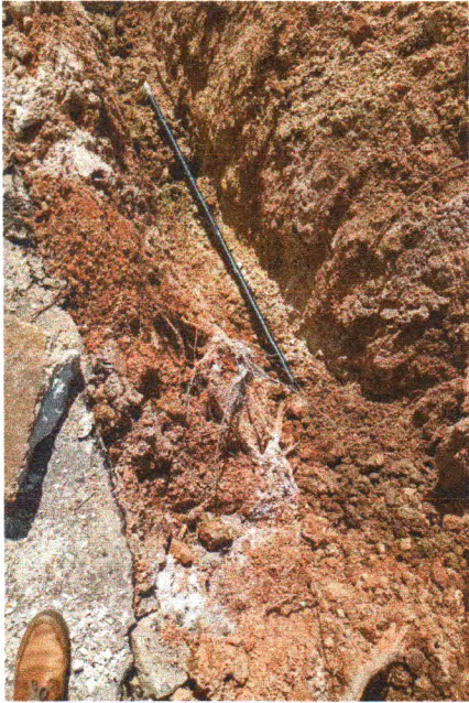
Tubulação de PVC enterrada
