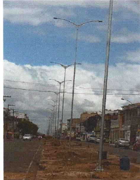
Postes de aço com luminárias
