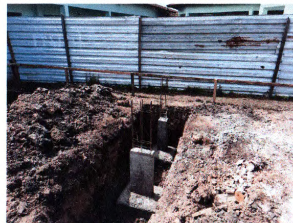
TAPUME EM CHAPA METÁLICA; ESCAVAÇÃO; LOCAÇÃO COM GABARITO DE MADEIRA; CONCRETO ARMADO SAPATAS E ARRAQUES DE PILAR
