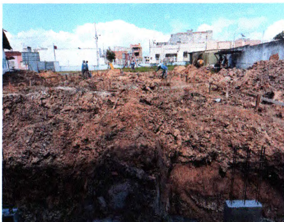
ESCAVAÇÃO; LOCAÇÃO COM GABARITO DE MADEIRA; CONCRETO ARMADO SAPATA E ARRAQUE DE PILAR
