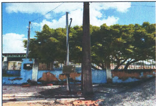
INST. PROVISÓRIA DE ENERGIA ELÉTRICA
