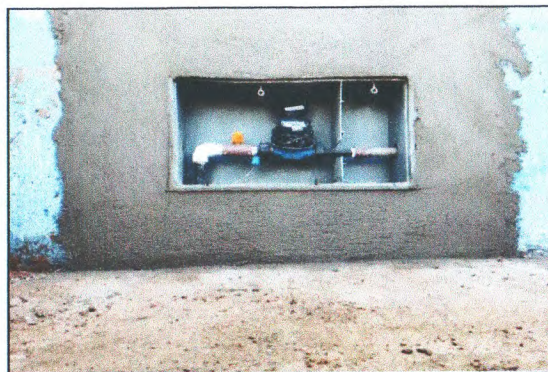
INSTALAÇÃO DE ÁGUA
