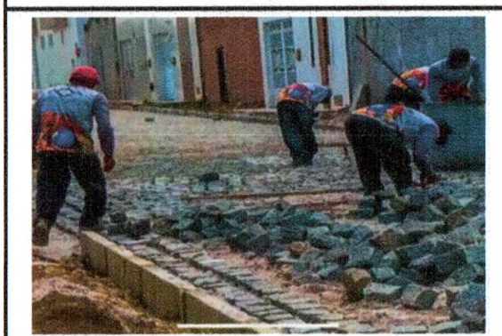
DRENAGEM SUPERFICIAL, COLCHÃO DE AREIA, ASSENTAMENTO DE MEIO FIO E PAVIMENTAÇÃO - MAURINO JOSÉ DA SILVA
