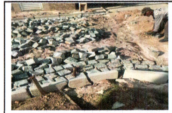
DRENAGEM SUPERFICIAL, COLCHÃO DE AREIA, ASSENTAMENTO DE MEIO FIO E PAVIMENTAÇÃO - MAURINO JOSÉ DA SILVA
