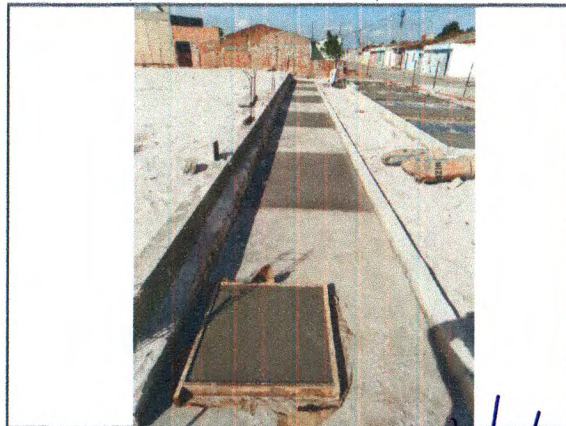
ASSENTAMENTO DE MEIO FIO; ATERRO COMPACTADO; LONA PLÁSTICA; PISO EM CONCRETO; TELA POLIETILENO
