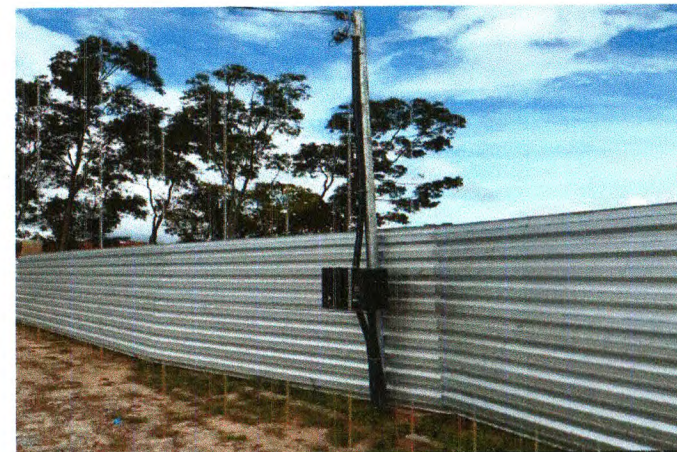
POSTE E QUADRO DE MEDIÇÃO
