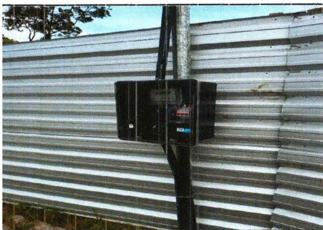
POSTE E QUADRO DE MEDIÇÃO
