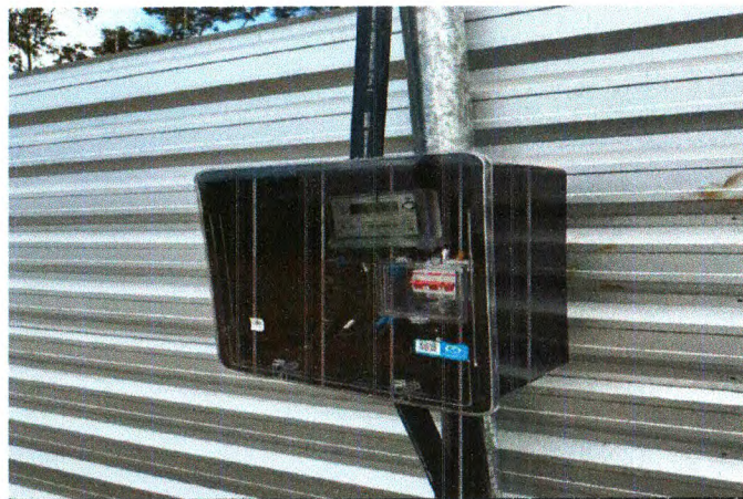
POSTE E QUADRO DE MEDIÇÃO
