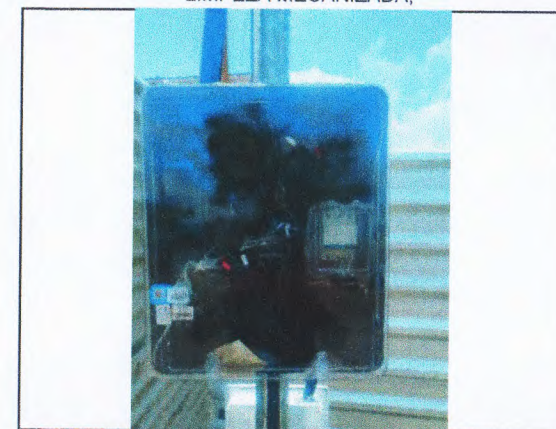
INSTALAÇÃO PROVISÓRIA DE ENERGIA;
