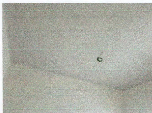
Forro de PVC
