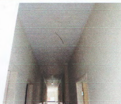
Forro de PVC
