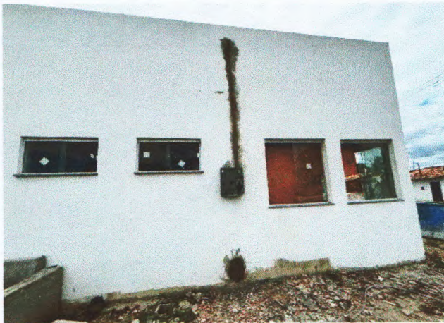
Instalação de padrão de entrada
