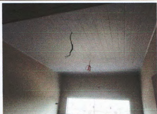
Forro de PVC
