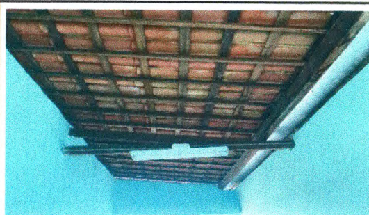
REVISÃO DE COBERTURA: ESCOLA MUNICIPAL JOSÉ FILADELFO ARAUJO
