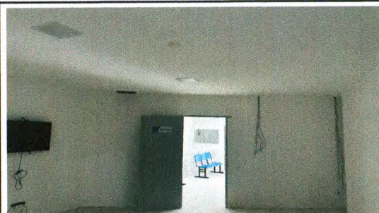
EMASSAMENTO, PINTURA, FORRO DE GESSO, INSTALAÇÃO DE PORTA, EXECUÇÃO DE PAREDE DE GESSO E REVISÃO DE PONTO DE LUZ - SEDE DA GUARDA MUNICIPAL
