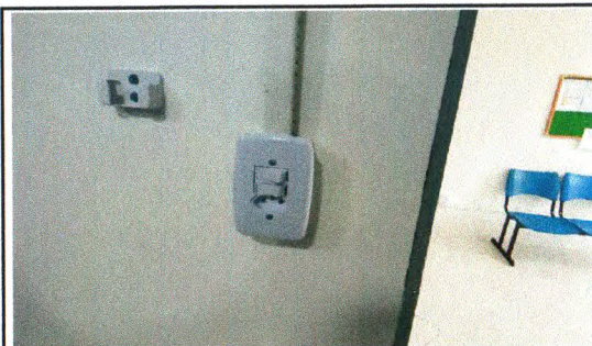
REVISÃO DE PONTO DE TOMADA - SEDE DA GUARDA MUNICIPAL
