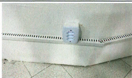
REVISÃO DE PONTO DE TOMADA - SEDE DA GUARDA MUNICIPAL
