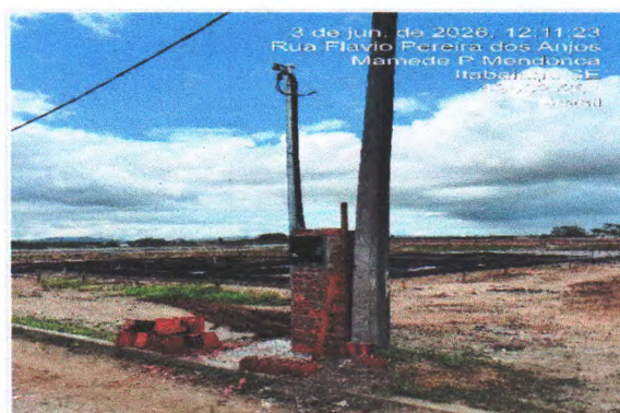
ENTRADA DE ENERGIA ELÉTRICA -10.673225, -37.426453
