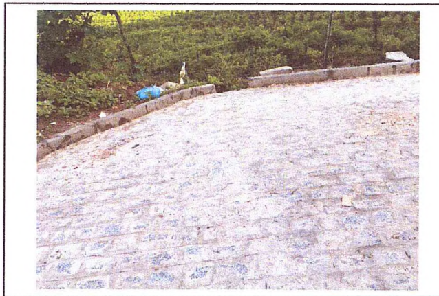
ASSENTAMENTO DE MEIO-FIO, DRENAGEM SUPERFICIAL E PAVIMENTAÇÃO - RUA VICE PREFEITO JOSIAS DA SILVA NUNES
