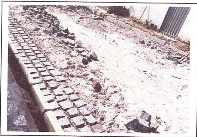
REGULARIZAÇÃO, COLCHÃO DE AREIA, PAVIMENTAÇÃO E ASSENTAMENTO DE MEIO FIO - TRAVESSA JOSÉ SIZINIO DE ALMEIDA 4
