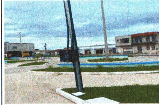
INSTALAÇÕES ELÉTRICAS E PADRÃO DE ENTRADA
