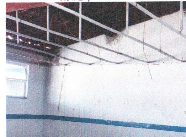
DEMOLIÇÃO DE FORROS DE PVC; REVISÃO DA COBERTURA EM TELHA CERÂMICA; INSTALAÇÃO ELÉTRICA
