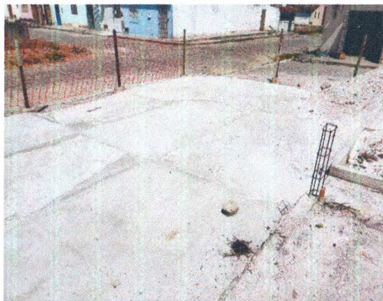
ASSENTAMENTO DE MEIO FIO; PISO EM CONCRETO; RAMPA PARA ACESSO DE DEFICIENTE
