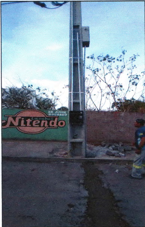
Figura 13: Instalação de medição e comando
