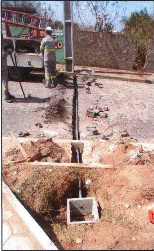
Figura 11: Inst. de eletroduto galvanizado medição
