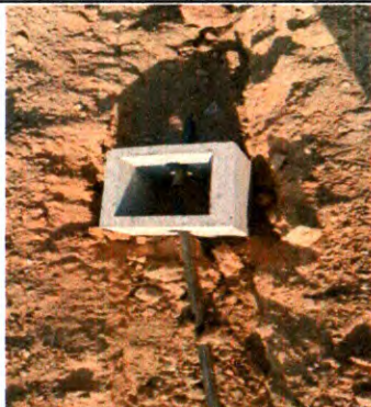
INSTALAÇÕES ELÉTRICA: CAIXA DE PASSAGEM E ELETRODUTO RÍGIDO
