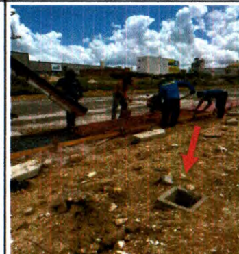
INSTALAÇÕES ELÉTRICA: CAIXA DE PASSAGEM E ELETRODUTO RÍGIDO
