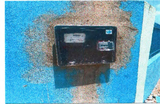
CAIXA DE MEDIÇÃO
