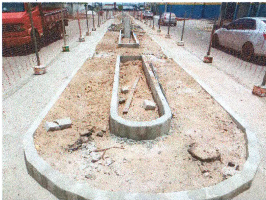
TAPUME DE PROTEÇÃO EM TELA; ASSENTAMENTO DE MEIO-FIO EM CONCRETO; REATERRO MANUAL
