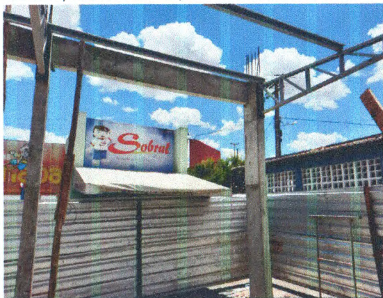
Estrutura treliçada da cobertura; Terças metálicas; Pintura sobre superfícies metálicas; Estrutura em concreto armado
