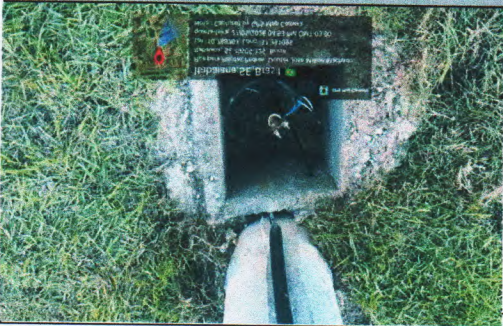
Imagem 11 - Caixa de passagem 0,40x0,40cm com aterramento das luminárias
