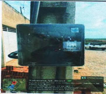
Imagem 9 - Cabo rígido de 10mm
