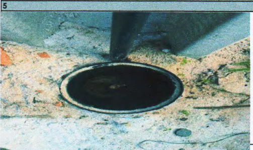
Imagem 5 - Caixa de aterramento e haste de aterramento
