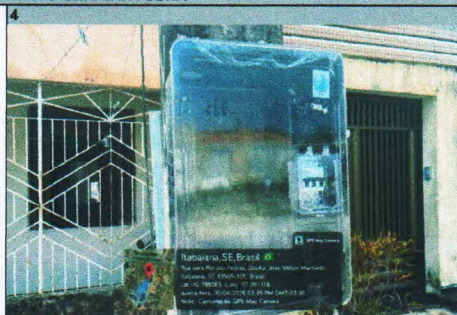
Imagem 4 - Caixa de medição e disjuntor tripolar 50A
