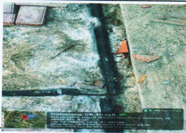
Imagem 8 - Eletroduto e luva pvc rígido de 1 1/4
