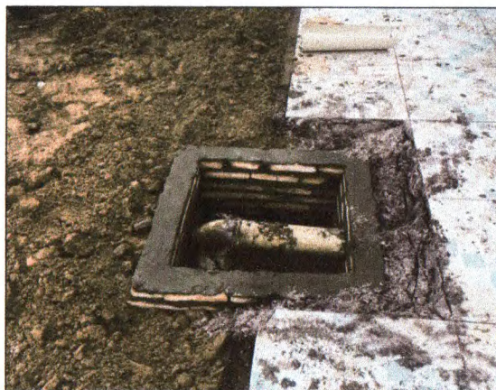
CAIXA DE PASSAGEM NA RUA PEDRO BARSOSA DE JESUS
