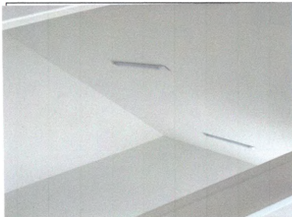
LUMINÁRIAS E FORRO DE GESSO COM PINTURA
