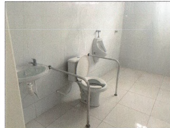
VASO, NICTÓRIO, PIA, BARRAS DE APOIO EM L
