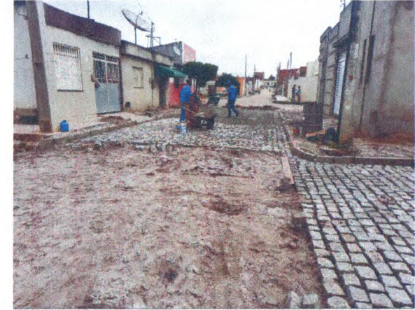
RUA JOSÉ VICENTE DE ALMEIDA - COLCHÃO DE AREIA; ASSENTAMENTO MEIO-FIO E PARALELEPÍPEDO
