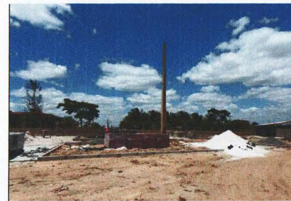
POSTE DE CONCRETO
