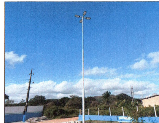
POSTE E LUMINÁRIAS
