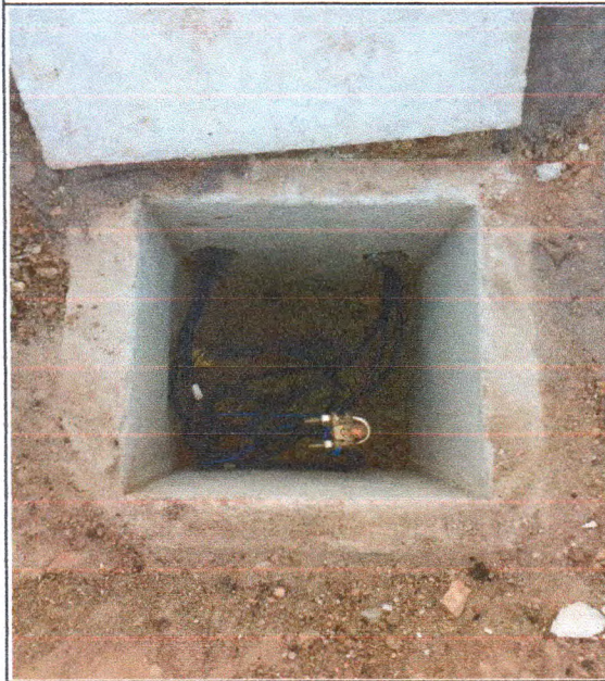
Caixa de passagem
