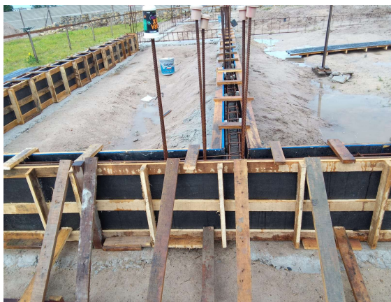
FERRAGEM; FORMA DE MADEIRA E CONCRETO DO VIGAMENTO INFERIOR DOS BLOCOS "B" E "C"
