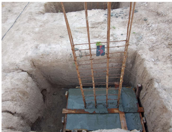
ESCAVAÇÃO; FORMA DE MADEIRA E CONCRETO DA SAPATA; FERRAGEM DO ARRANQUE DO PILAR
