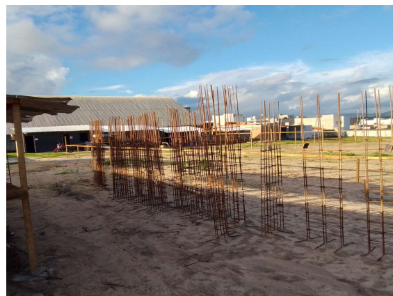
CORTE E DOBRA DAS FERRAGENS PARA A FUNDAÇÃO DAS EDIFICAÇÕES DO BLOCO C E DO BLOCO B
