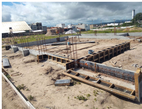
FERRAGEM; FORMA DE MADEIRA E CONCRETO DO VIGAMENTO INFERIOR DOS BLOCOS "B" E "C"
